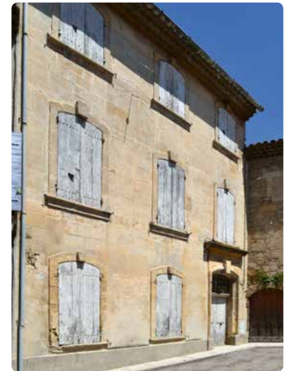
Exemple de RAVALEMENT D'ENTRETIEN à réaliser
