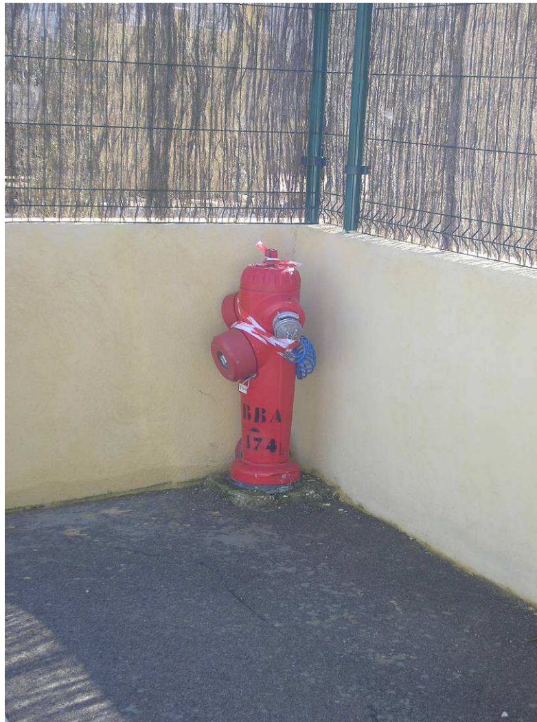
Photo : mesure de pression en continu sur le poteau incendie situé avenue Racine (référence SDIS n°174)
