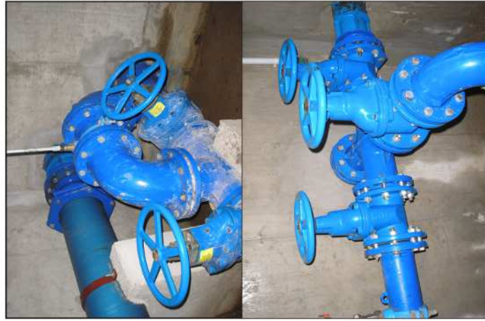
Chambres de vannes Bassin n°2
