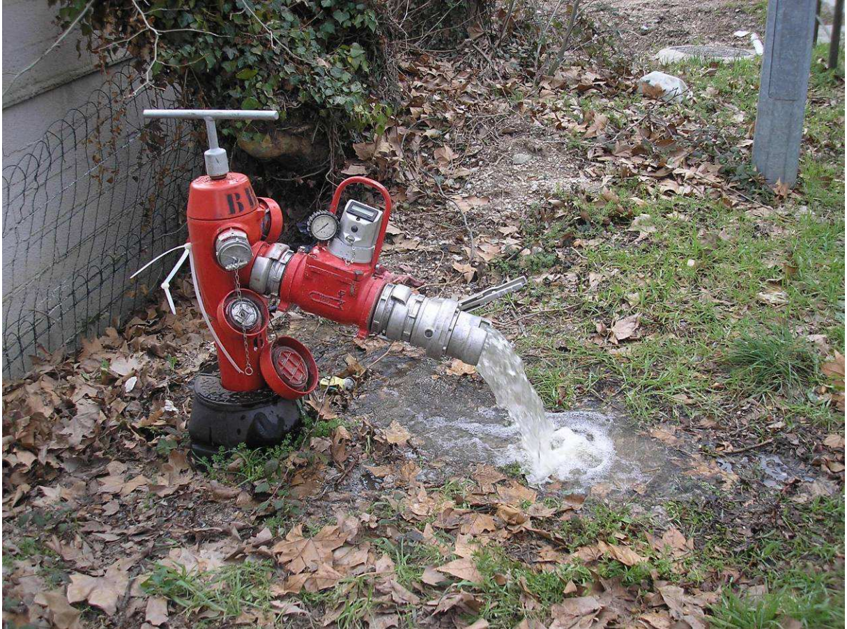
Photo : mesure d'encrassement du réseau sur le poteau incendie situé avenue de la Croix d'Or (référence SDIS n°60)
